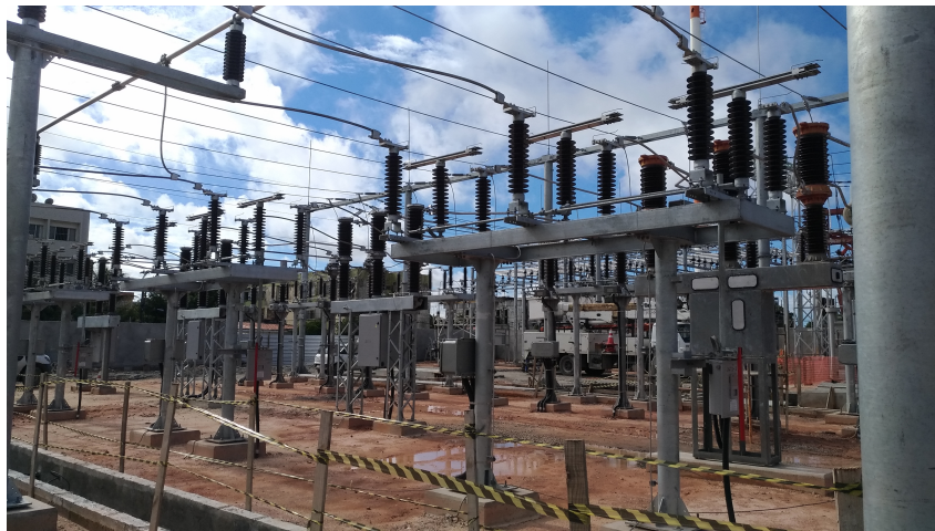
Figura 10 – TC's e TP's da seção 69kV.
