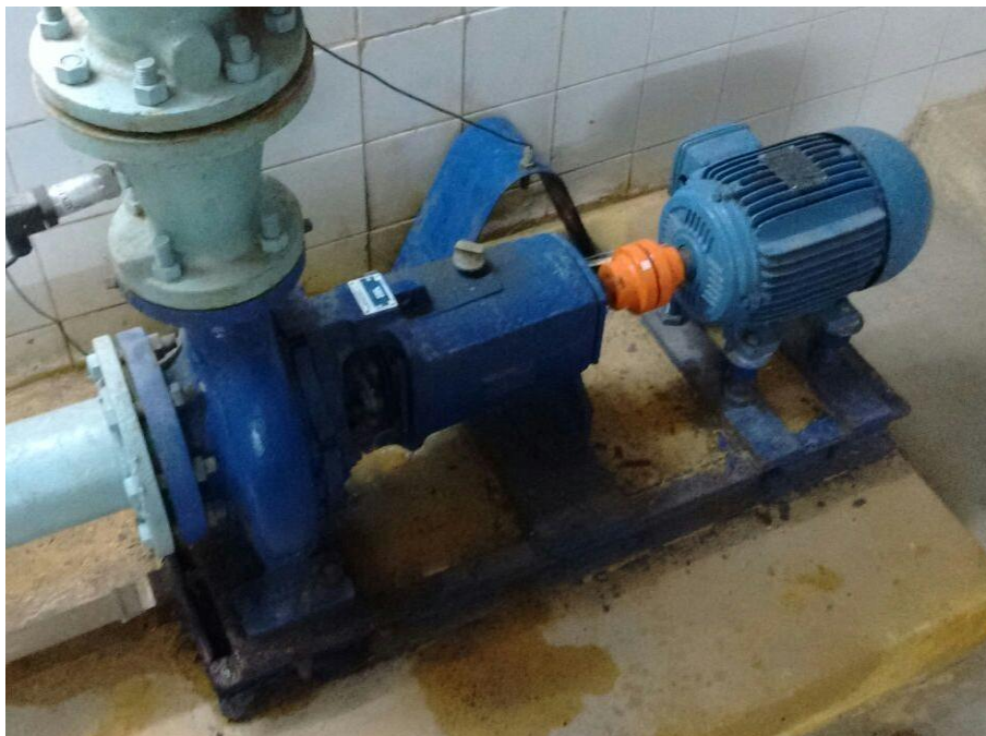
FIGURA 10 -CONJUNTO MOTOR ELÉTRICO MAIS BOMBA.
