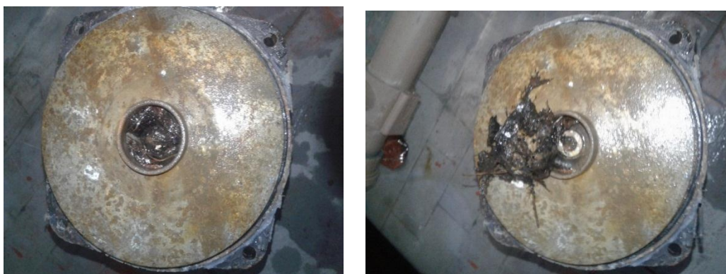
FIGURA 19 – FOTO 1 DA MOTOBOMBA 1 OBSTRUIDA
