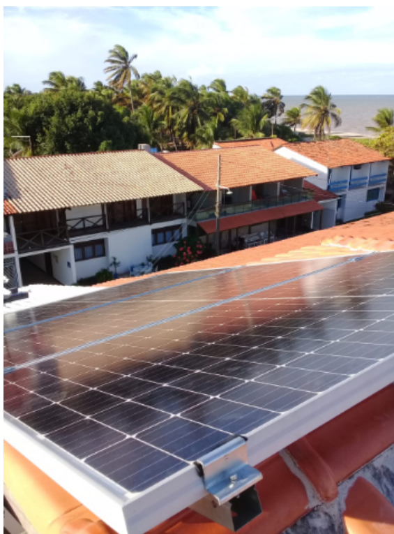
Figura 28: Sistema fotovoltaico do cliente 2 instalado.
