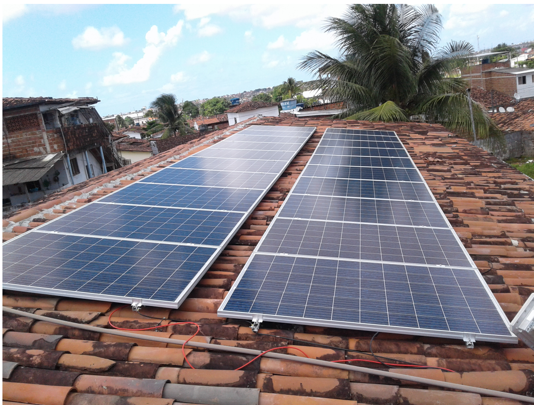
Figura 26: Sistema fotovoltaico do cliente 1 instalado.
