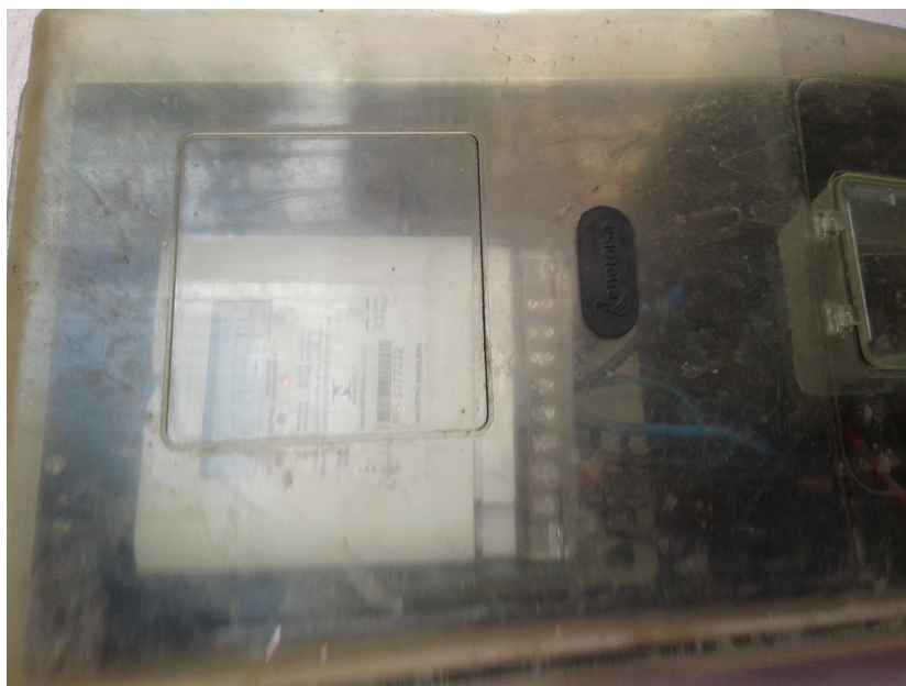
Figura 23: Medidor de energia convencional.
