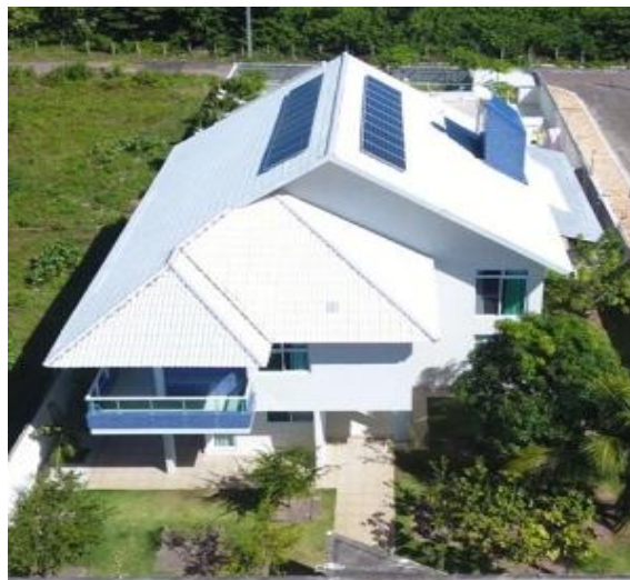
Figura 5-SFCR com dois arranjos fotovoltaicos
