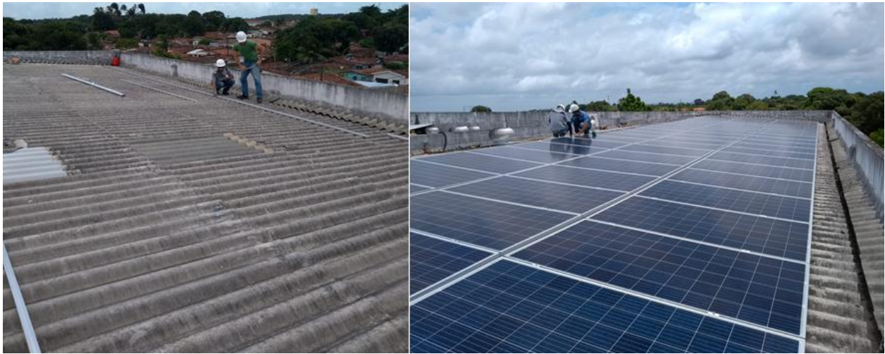
Figura 21-Processo de fixação dos trilhos e painéis no telhado da Via Campo Rações e Medicamentos Veterinários
