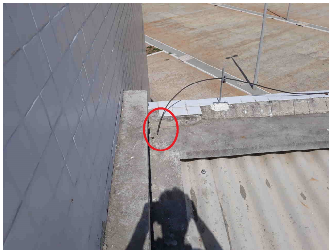
Figura 11 – Malha captora de SPDA com descontinuidade.
