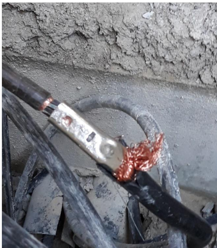
Figura 14 – Má conexão de cabos do ramal de alimentação.
