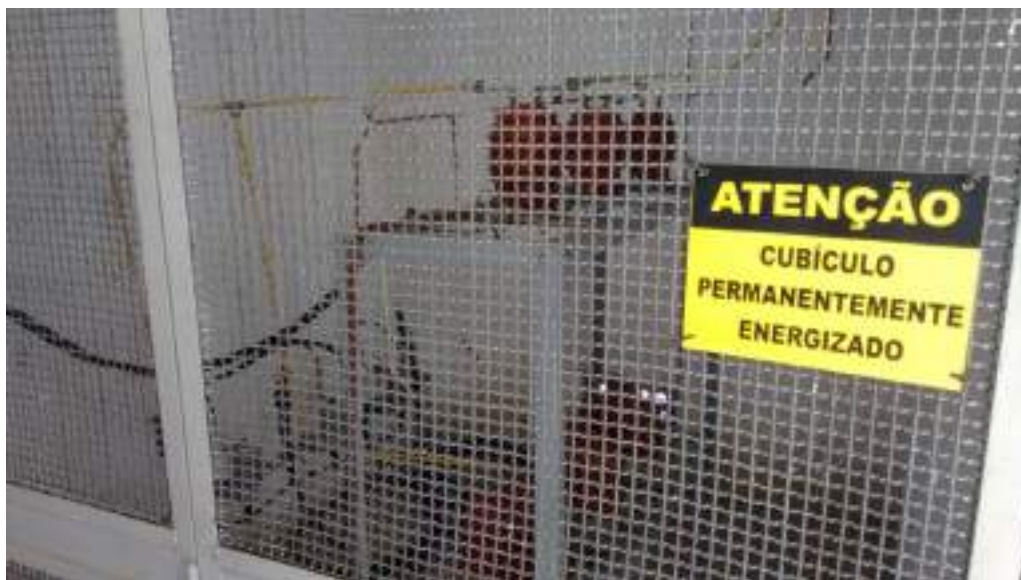
Figura 7 – Transformadores de potencial e de corrente do cubículo de medição.
