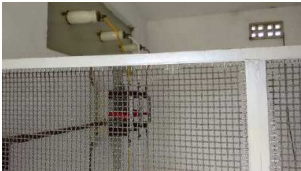
Figura 6 – Alimentadores dentro do cubículo de medição.
