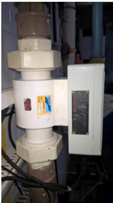
Figura 3.5- Transdutores de vazão da Incontrol.
