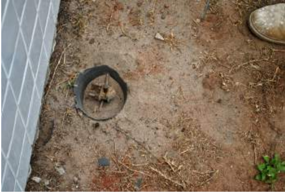
Figura 5.10: Caixa de aterramento a menos de 1 m da parede
