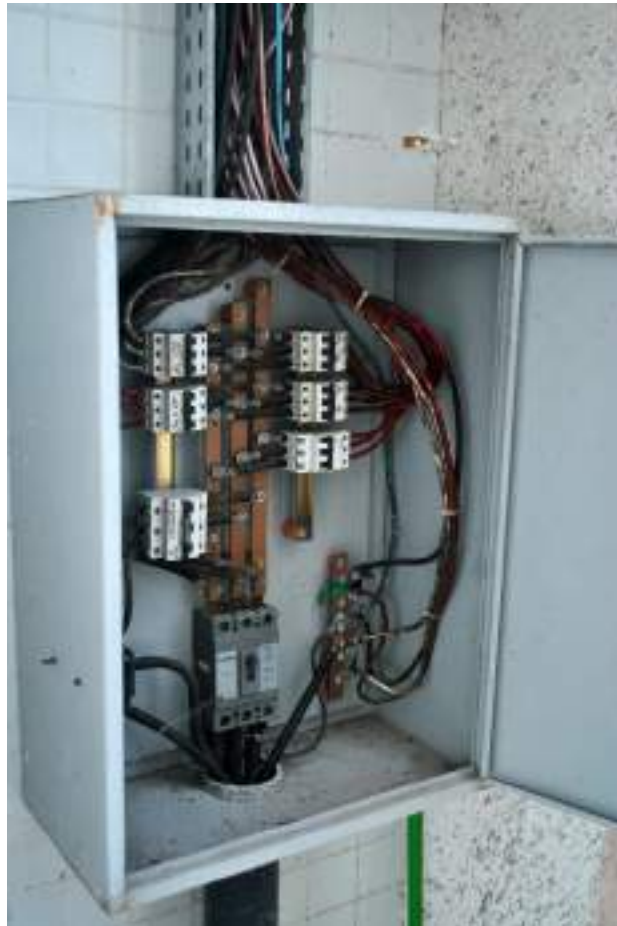
Figura 5.12: Quadro sem DPS e sem equipotencialização
