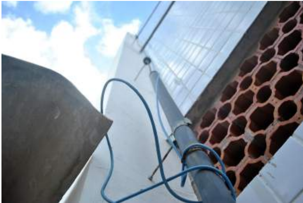
Figura 5.6: Não existe caixa de ensaio
