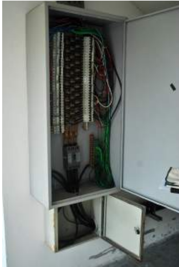
Figura 5.13: Quadro sem DPS e sem barramento de equipotencialização
