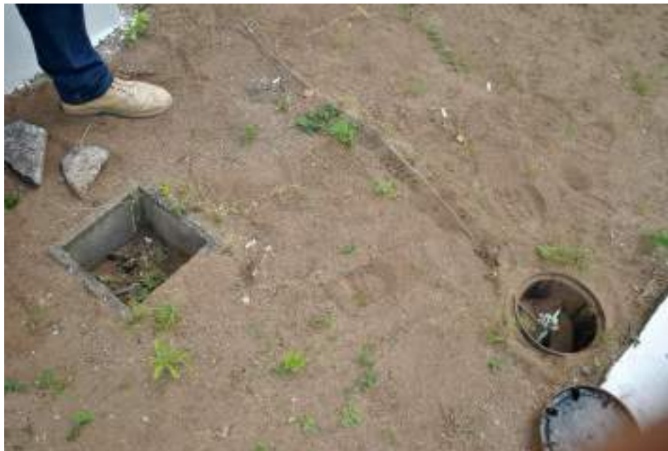
Figura 5.8: Cabo exposto e conector sem massa de calafetar
