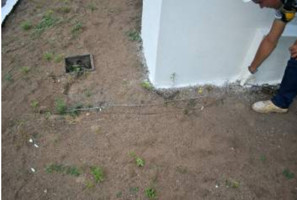
Figura 5.9: Cabo exposto não aterrado
