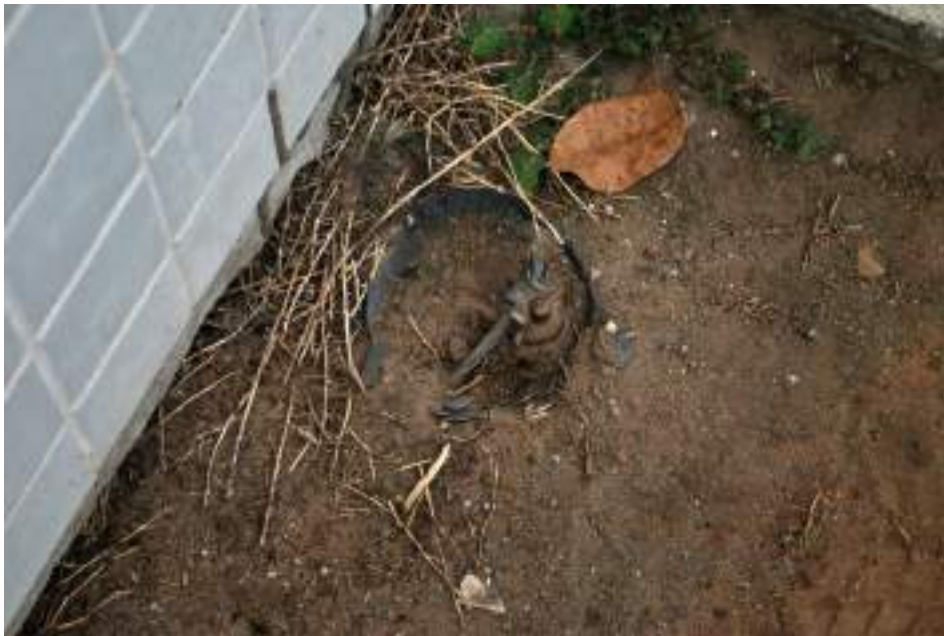
Figura 5.11: Caixa de Aterramento em condições precárias
