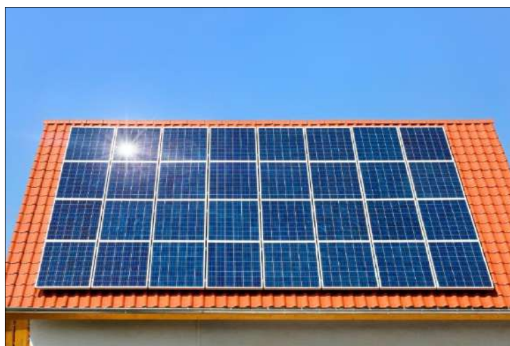
Figura 5: Painéis Fotovoltaicos Instalados no Telhado
