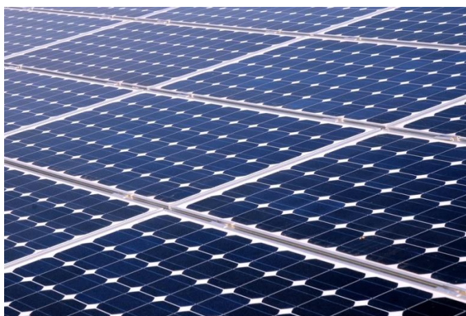
Figura 31 - Conjunto de painéis fotovoltaicos.
