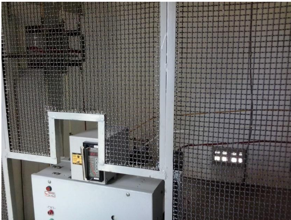
FIGURA 18. POSTO DE PROTEÇÃO.
