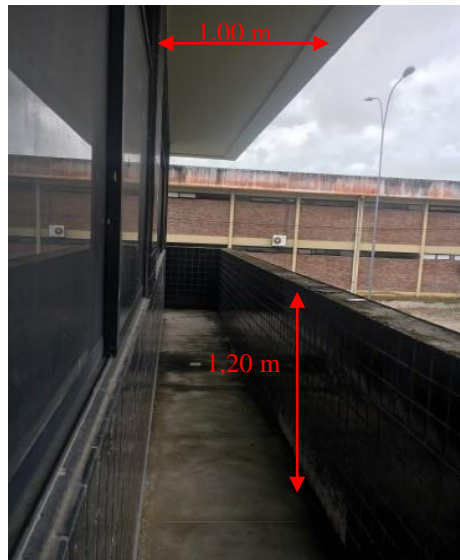
9b - Varanda técnica com acabamento em cerâmica 10cm x 10cm na cor preta, teto em forro de gesso com pintura branca acrílica fosca e esquadrias das salas com perfil em alumínio, pintura preta e vidro fumê
