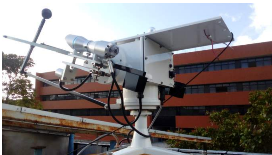
Figura 69. SunTracker EKO® instalado na estação meteorológica do CEAR. Fonte: Autorialia própria.
