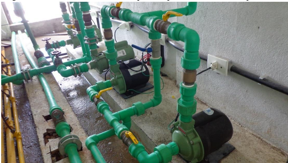
Figura 18. Bombas SCHNEIDER que compõem o sistema de aquecimento
