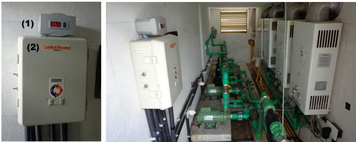
Figura 19. Controlador de temperatura e sistema de aquisição de dados. Disposição na instalação
