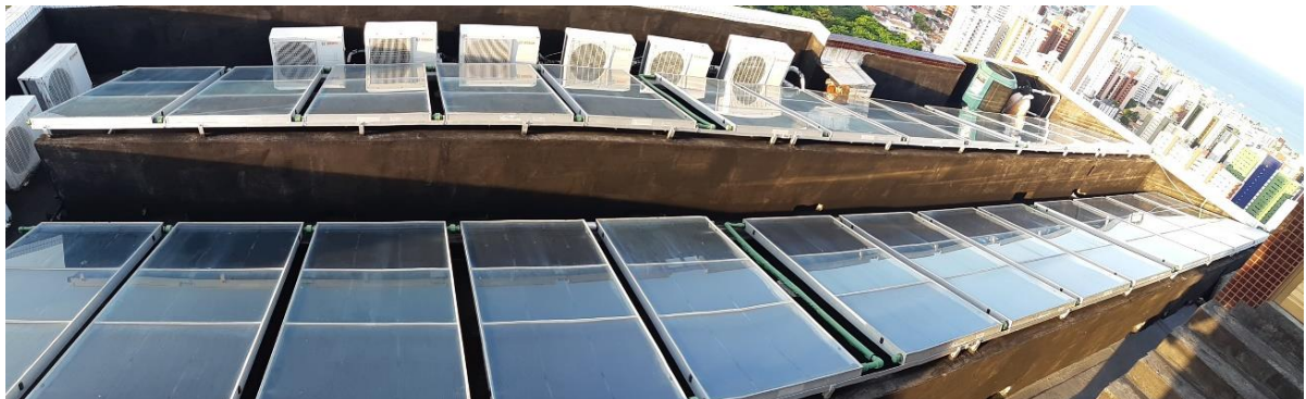
Figura 13. Parte dos coletores TRANSSSEN, modelo Porto Seguro v2.0, instalados no edifício
