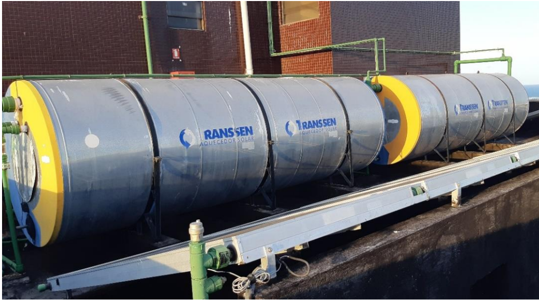
Figura 15. Boilers instalados em série na cobertura do edifício
